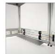
踢腳板走線 (強弱電分線)
